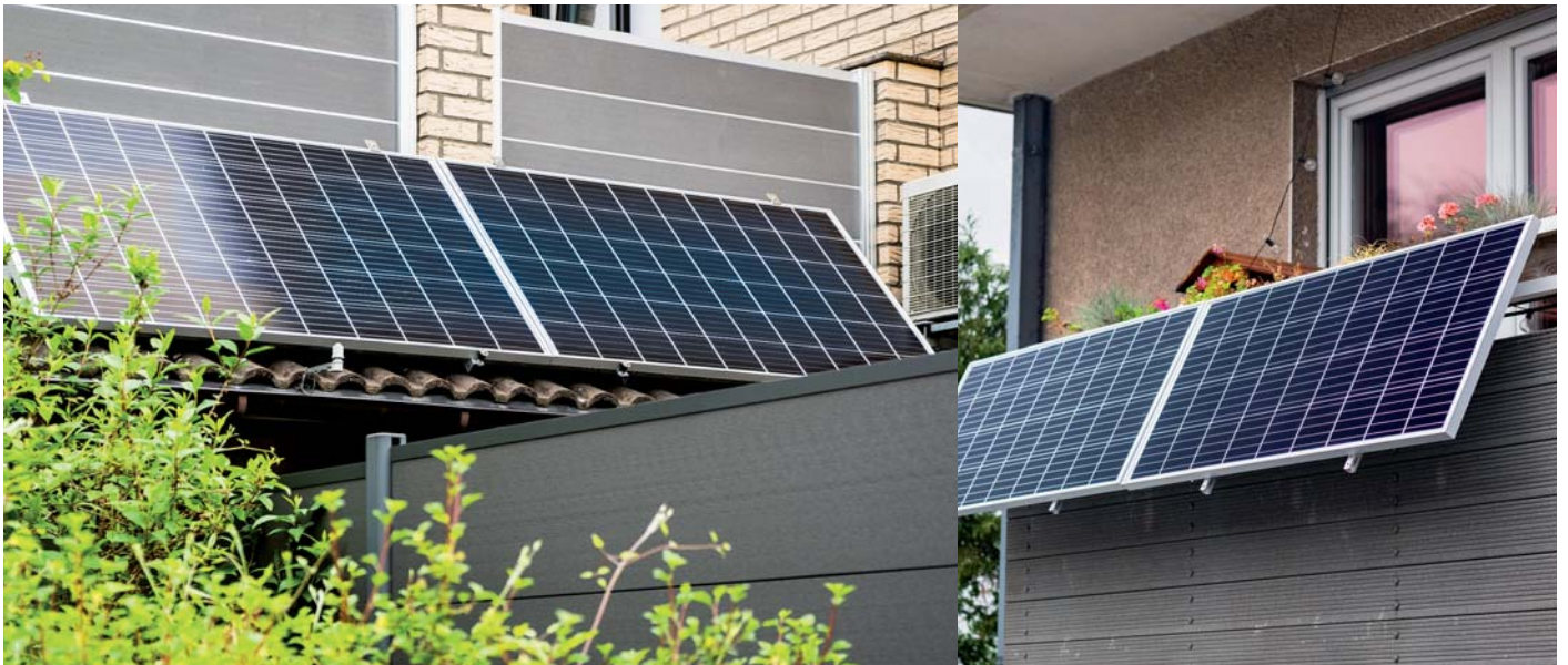
Photovoltaik-Kleinstanlagen am Balkon
